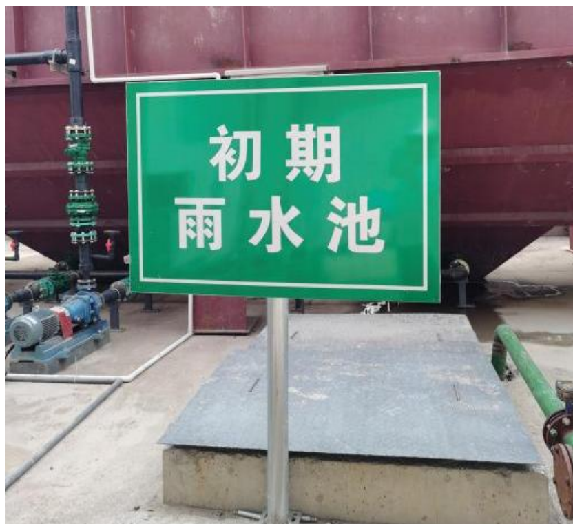
图 2-4 初期雨水收集池
