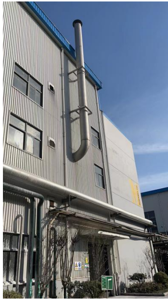
含氨废气排气筒
